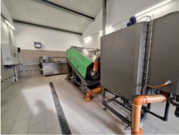
Rozbudowa i modernizacja oczyszczalni ścieków w Kiełczyńku Całkowita wartość inwestycji: 19 179 371,30 zł Dofinansowanie: 9 500 000,00 zł
