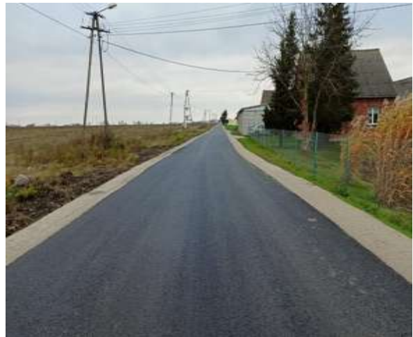
Budowa dróg dojazdowych do gruntów rolnych: Przebudowa drogi w Mchach Całkowita wartość inwestycji: 488 731,00 zł Dofinansowanie: 120 000,00 zł
